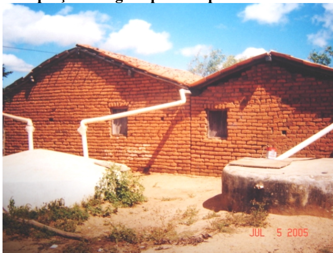
FOTO IV - Captação de águas pluviais para as cisternas
